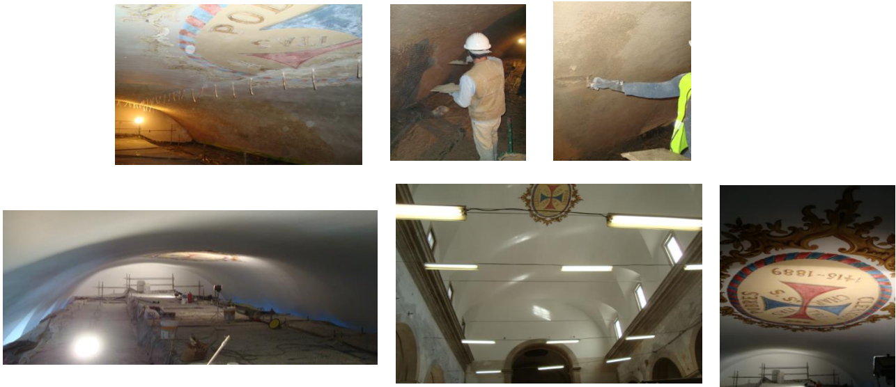
Figura 3. Preparação, aplicação do sistema de reforço e aspecto final dos trabalhos de reforço da abóbada da nave da Igreja de Santa Marta em Lisboa
